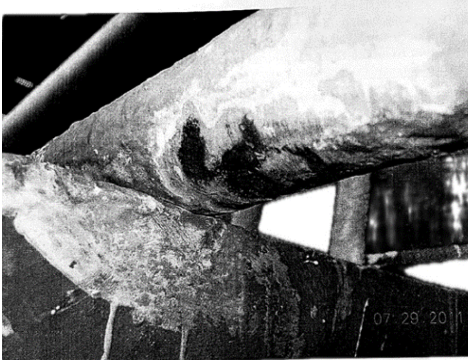
Şəkil 2 – MKQ-də dayağın yaxınlığında boru qüsurlarının xarici görünüşü Figure 2 – External appearance of pipeline defects near the support in the CComU
